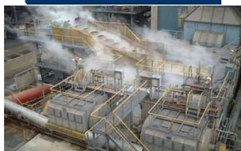
水砕スラグ製造設備
